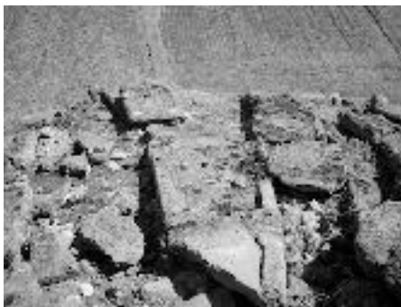
Sur la toiture, le désordre
